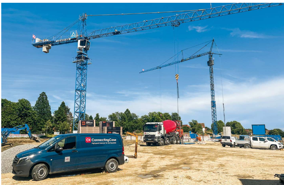
Für jede Baustelle und für jede Situation gibt es eine passende Anlage von Connecting Case für stabilen und leistungsstarken Internet-Empfang. Quelle: Connecting Case
